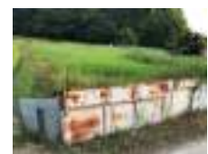
トタン板の防除柵
