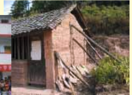
↑今にも崩れそうな学校
