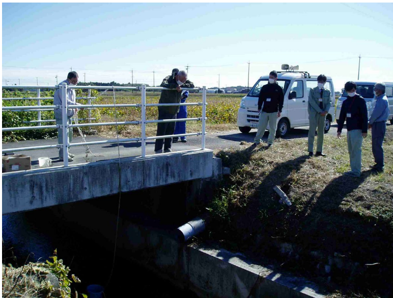
大口川上流用水路(Mi 農場そば排水口の上流付近、やや臭気あり)
